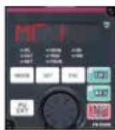
「Maintenance1輸出」警報
